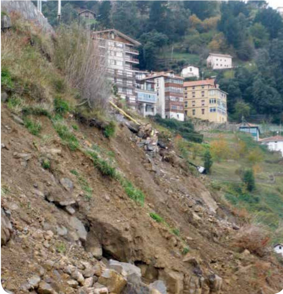
Detalle de los desprendimientos.
