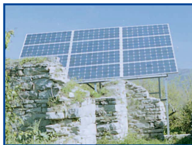
Paneles solares en una explotación agrícola.
