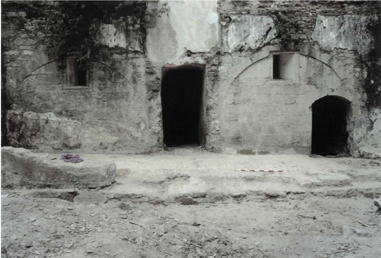
El polvorín de La Magdalena una vez efectuada la limpieza por el campo de trabajo.
