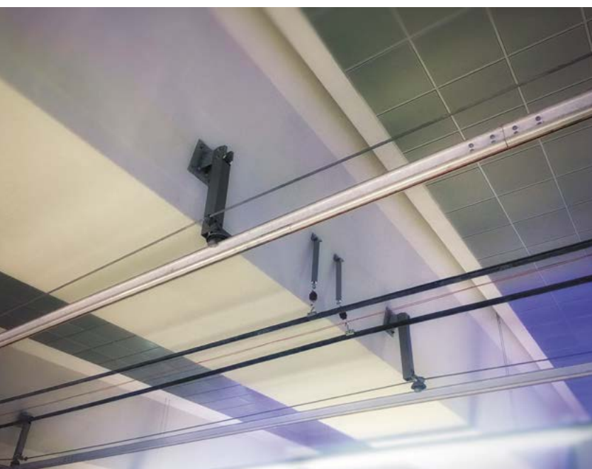
3. lineako tunel osoan zehar katenaria zurrun sistema instalatu da.
