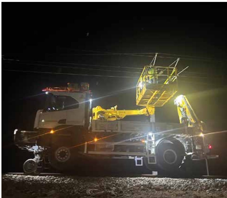
107. argazkia. Armazoiaren babes kolektiboak behar bezala instalatuta.
