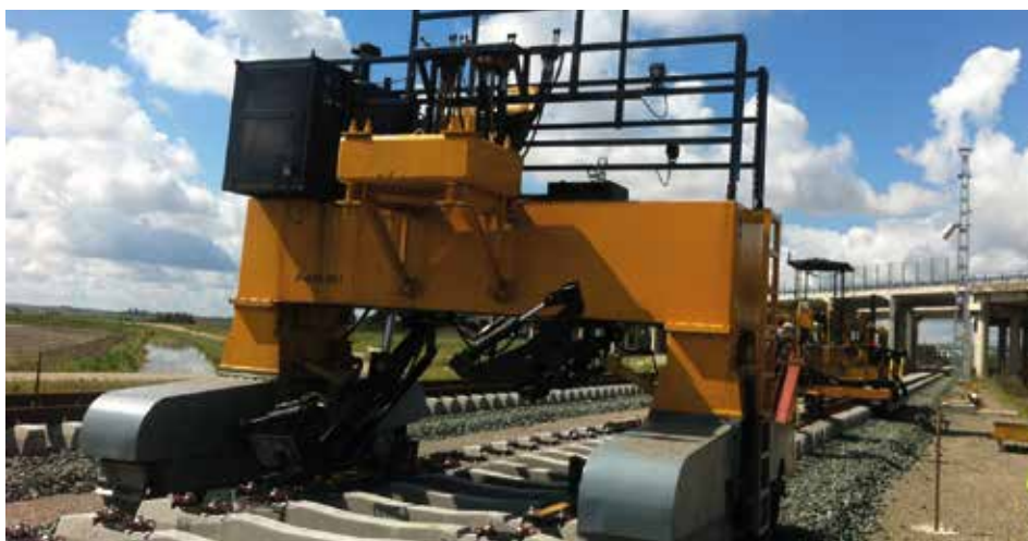
Fotografía 138. Pórticos de vía.
