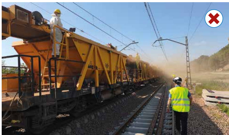
Fotografía 24. Exposición a polvo generado con alto contenido en sílice cristalina respirable que requiere medidas de prevención adecuadas.
