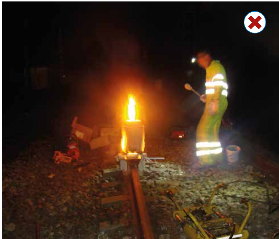
Fotografía 87. Distancia de seguridad al crisol incorrecto y ausencia de EPI adecuados.
