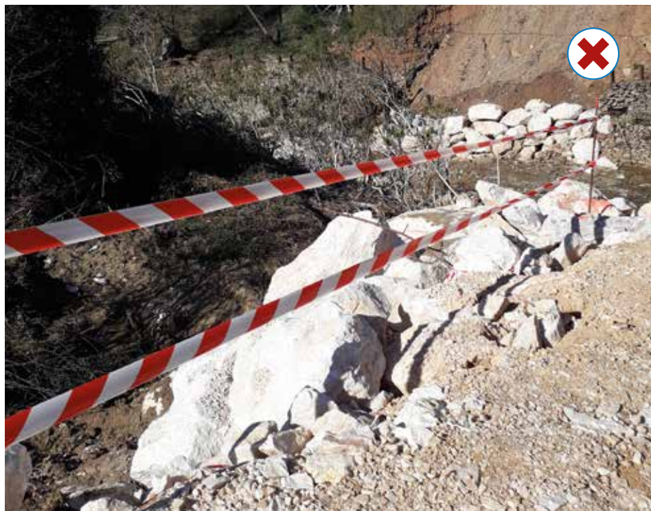
Fotografía 59. Riesgo de caída de personas a distinto nivel. Balizamiento al borde, a distancia no adecuada.
