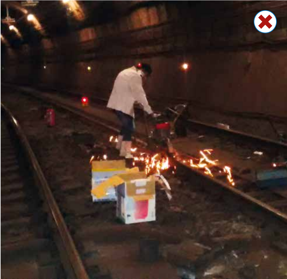
Fotografía 77. Riesgo de incendio. Entorno no libre de materiales.
