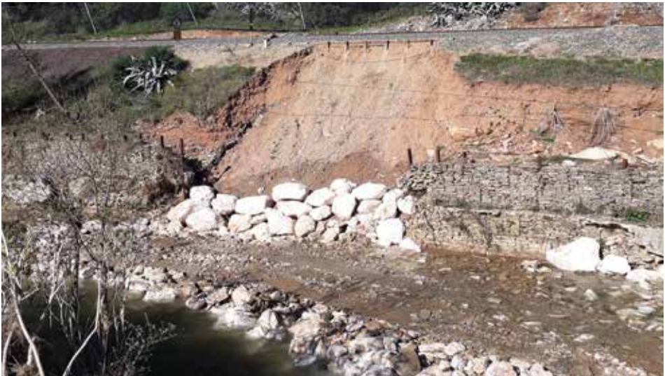
Fotografía 58. Trabajos a planificar las medidas de protección frente al riesgo de caída de altura.
