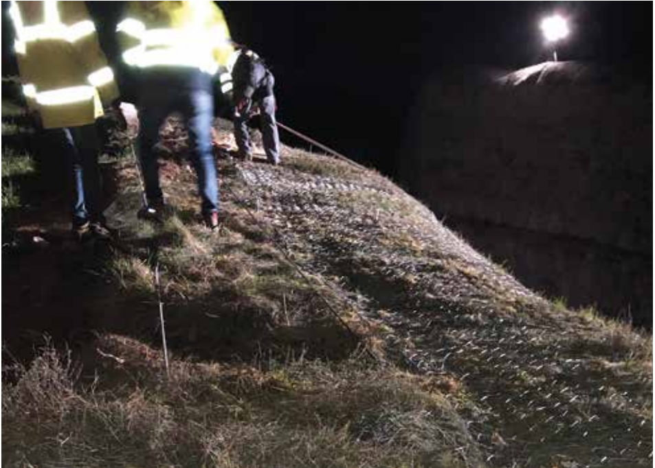
Fotografía 60. Riesgo de caída de altura, donde no es viable la instalación de protecciones colectivas, se dispondrá de medios de protección individual
