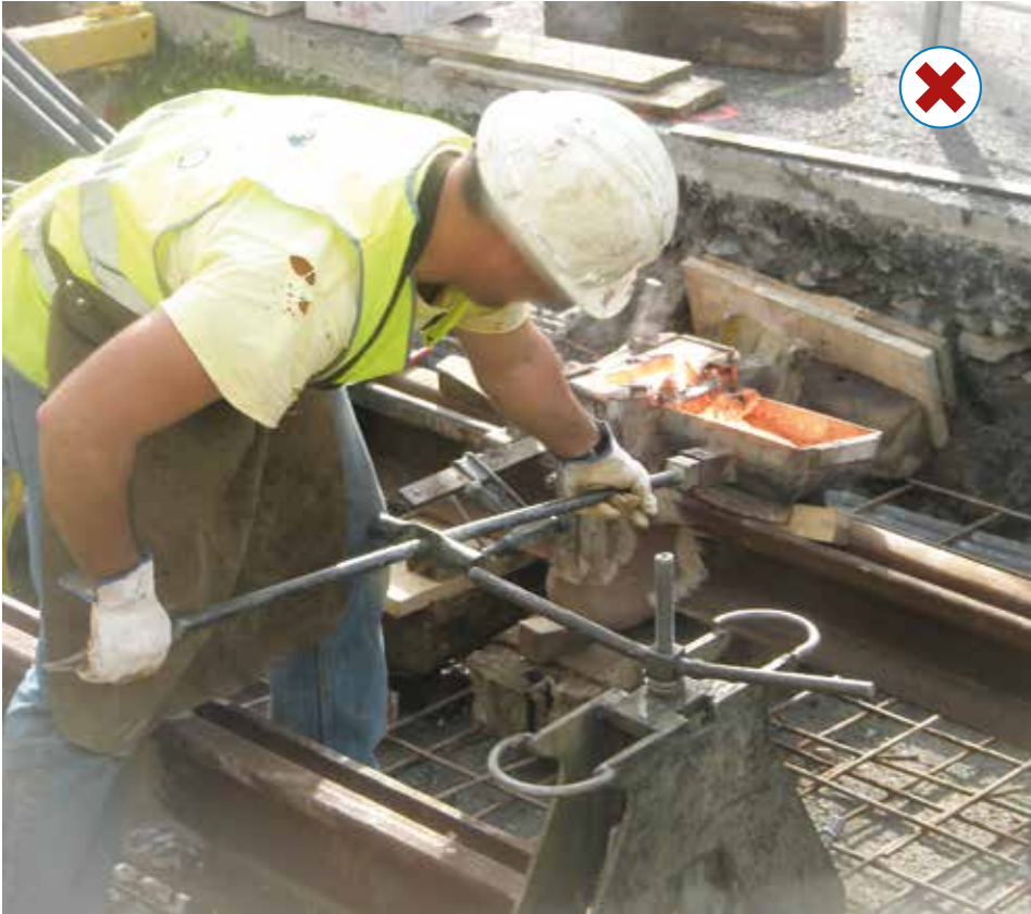
Fotografía 85. Retirada de restos calientes sin hacer uso de los EPI adecuados.
