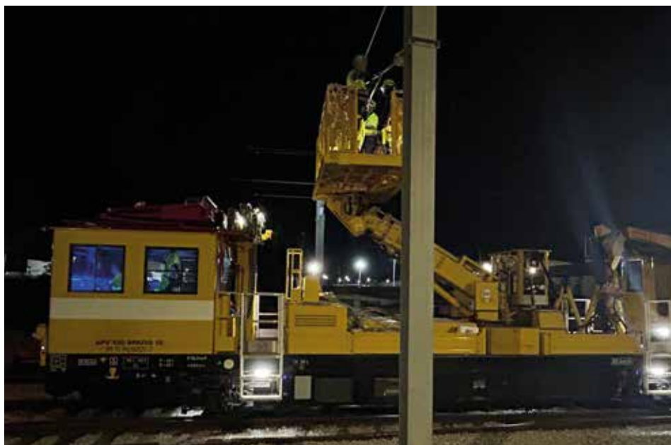
Fotografía 125. Dresina con castillete de elevación o grúa .
