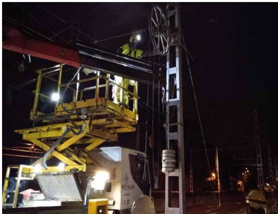
Fotografía 112. Protecciones colectivas del castillete.
