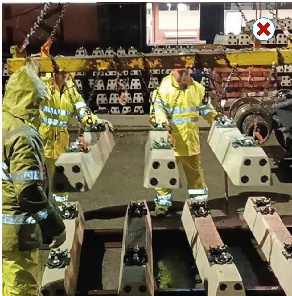
Fotografía 93. Riesgo de caída de objetos en manipulación. No se guarda distancia de seguridad a la carga que se está transportando.
