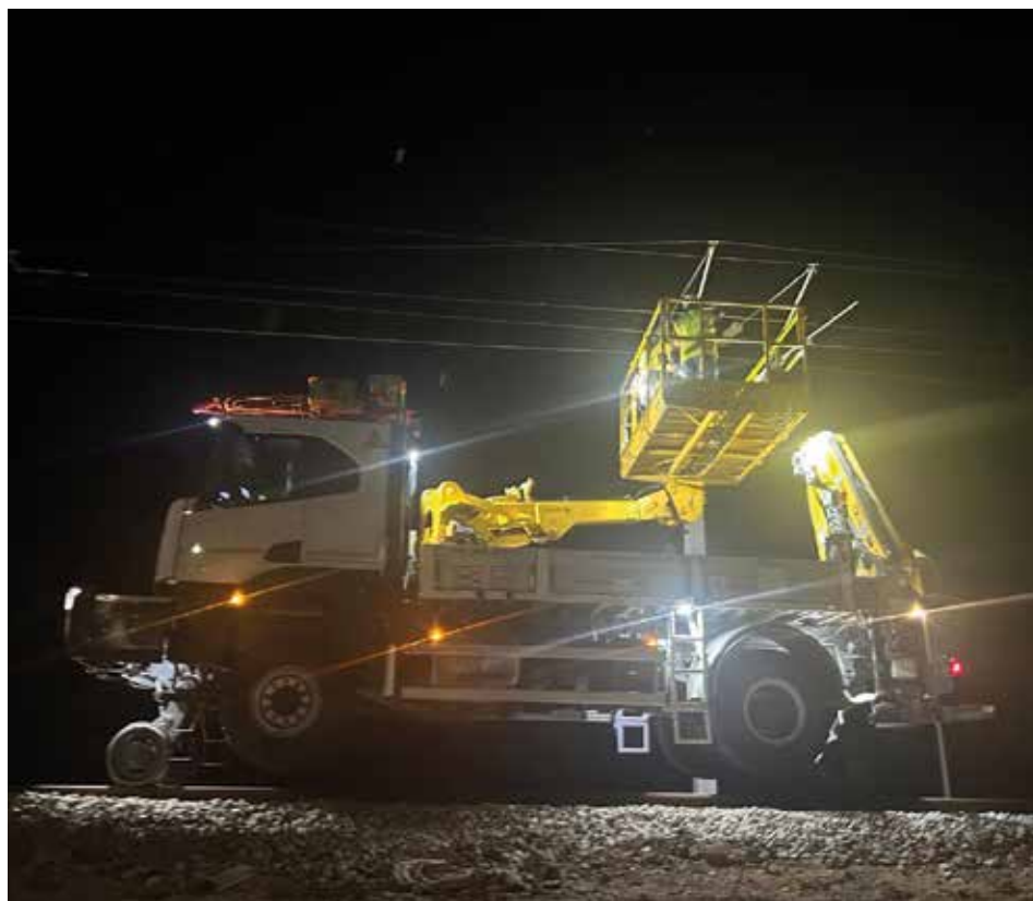
Fotografía 107. Protecciones colectivas del castillete correctamente instaladas.
