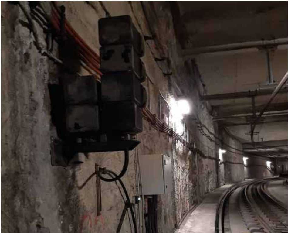
Fotografía 119. Instalaciones fijas existentes en túnel.
