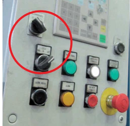
2. argazkia: makinako aginte-taula ez da ergonomikoa, modu berean eragindako bi aginte berdin daudelako elkarren ondoan, nahiz eta haien funtzioak desberdinak izan. Hori dela eta, erroreak gertatu ahal izango dira.
