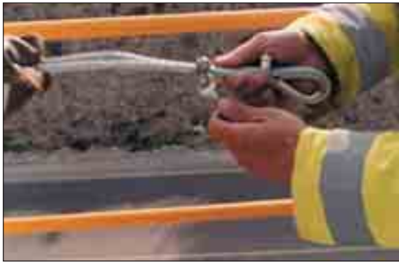
Reajuste del cable guía mediante un conjunto sujetacables para acotar la distancia deseada.
