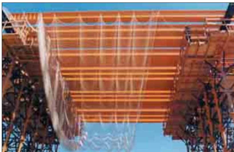
La red de seguridad se instala de forma sencilla y segura. En éste caso el trabajador lo hace desde la plataforma de seguridad con la ayuda de una cuerda.
