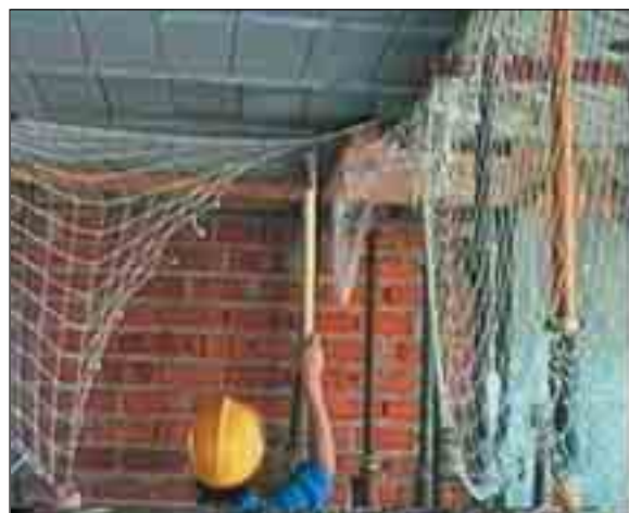
Finalmente se cortará la red para poder desencofrar, recuperar material y continuar con la ejecución de la estructura.
