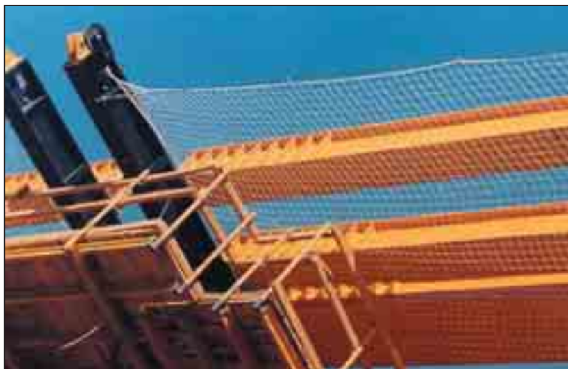
Red de Seguridad tipo toldo instalada. La red tipo toldo garantiza libertad de movimientos y protección a varios trabajadores simultáneamente.
