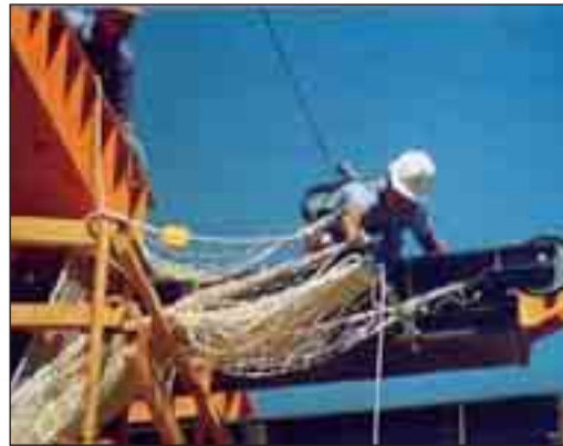
Montaje de red tipo toldo en cables guía aplicando métodos de alpinismo.
