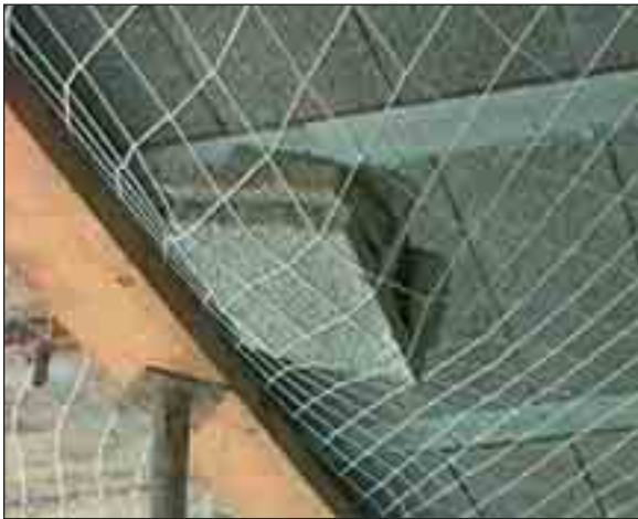
Las redes evitan la caída del material encima de los operarios y contribuyen a la higiene de la obra.
