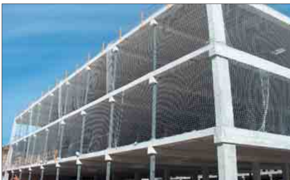
Redes de cierre de protección vertical.
