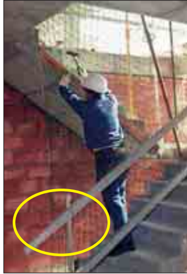
Las barandillas por causas de exceso dimensional provocan accidentes.
