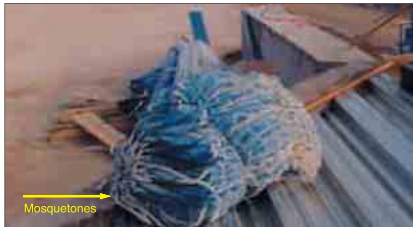
Red de seguridad sistema T "tipo toldo".
