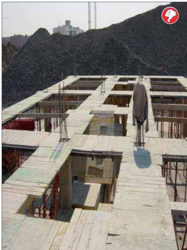
Habeak eta kontramailak enkofratzean, forjatuaren hutsunetik maila batetik bestera erortzeko arriskua
