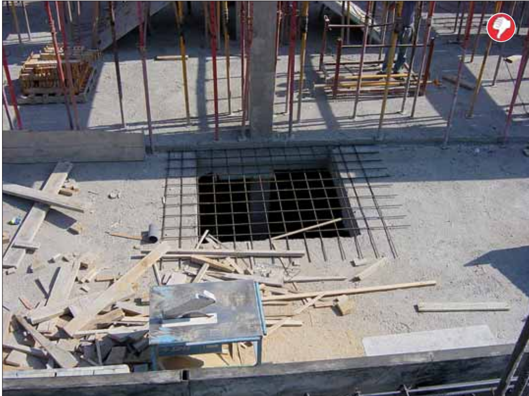
Orden y limpieza, protección inadecuada de hueco horizontal: posible desplazamiento del mallazo y ausencia de barandilla
