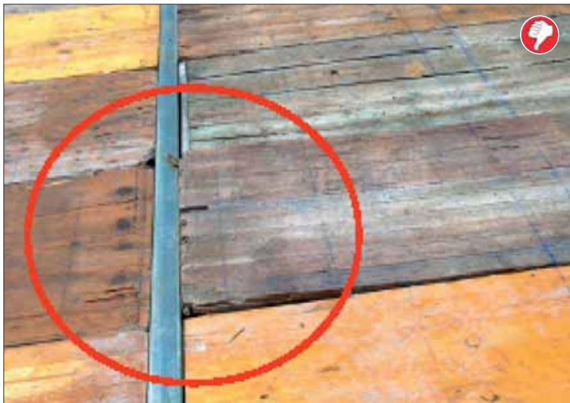
Mal ajuste de tableros de encofrado por su deterioro y diferentes procedencias
