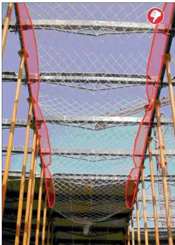
Red bajo forjado recuperable: faltan ganchos de sujeción en zonas sombreadas en rojo
