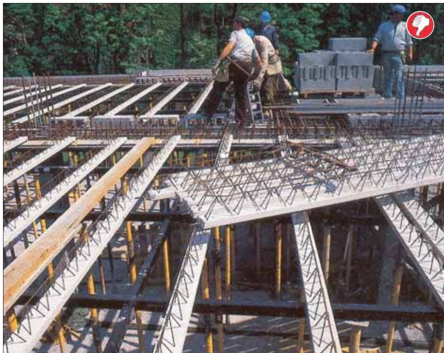
Riesgo de caída a distinto nivel hacia el interior del forjado durante la colocación de vigueta
