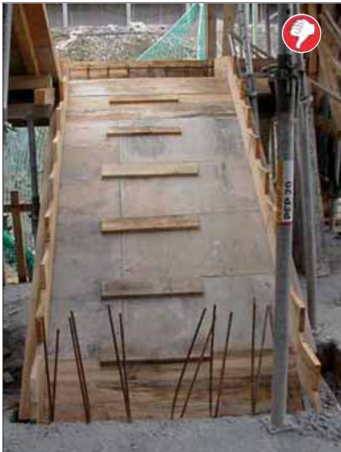
Acceso inadecuado a planta superior y sin protección de esperas
