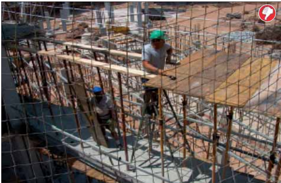
Montaje de encofrado desde nivel inferior sobre plataforma inadecuada
