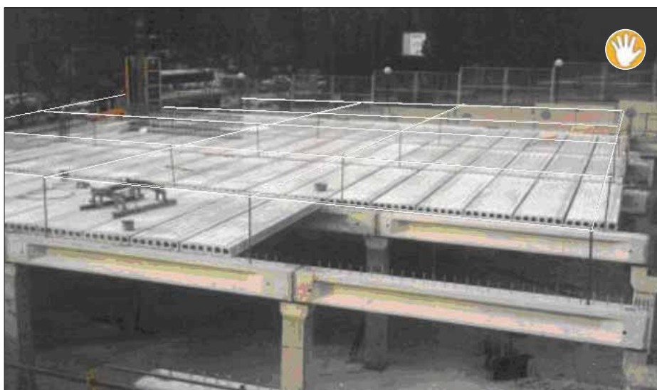
Forjado de losas prefabricadas alveolares, con línea de vida para evitar riesgo de caída a distinto nivel
