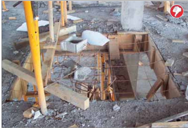
Puntales con apoyo deficiente
