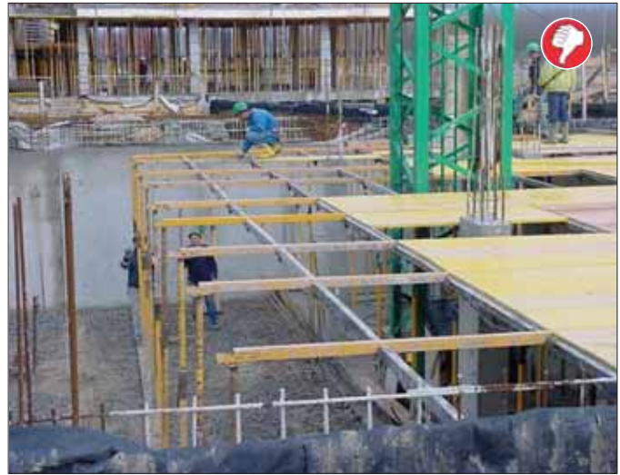
Riesgo de caída a distinto nivel durante el entablado de encofrado continuo
