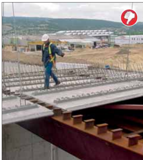
Trabajos con riesgo de caída a distinto nivel: operario sin protección
