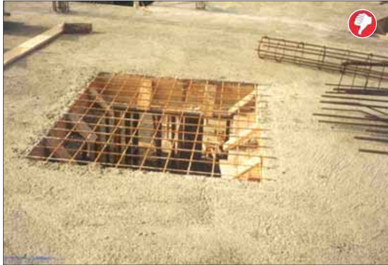
Protección incompleta de hueco
