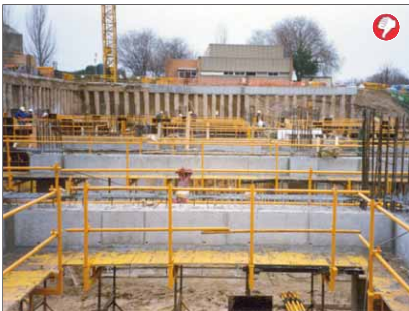
Protección de caída a distinto nivel mediante barandilla sin rodapié
