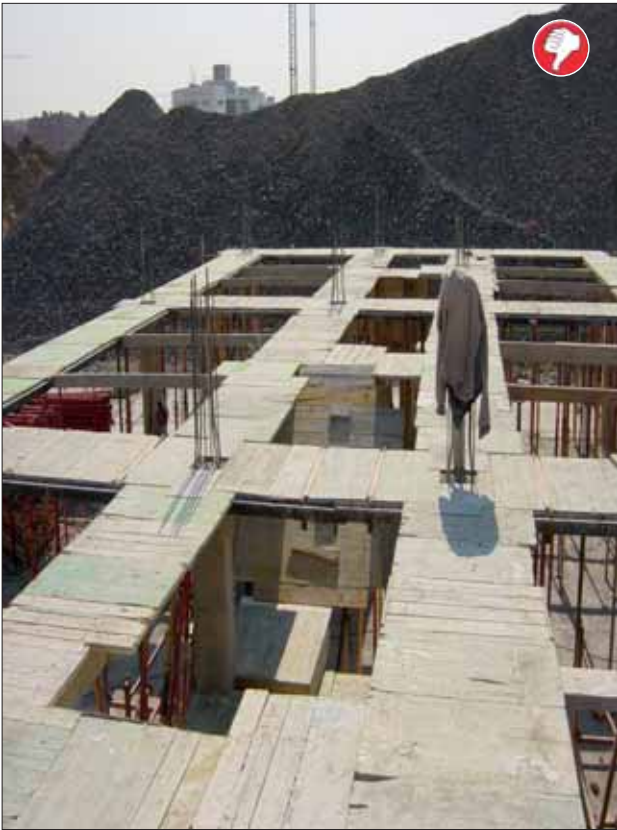
Riesgo de caída a distinto nivel hacia el interior del forjado durante el encofrado de vigas y tabicas
