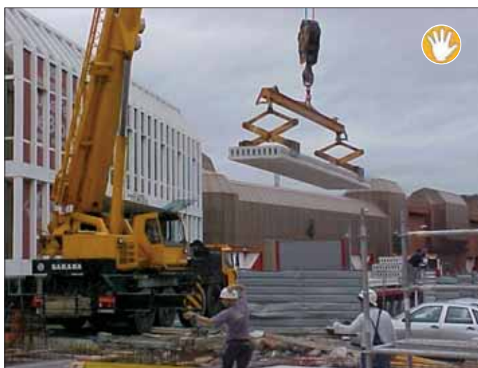
Empleo de accesorios de elevación adecuados y personal fuera del radio de acción
