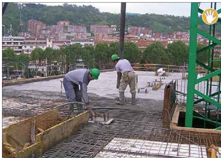
Riesgo de caída a mismo nivel por trabajos sobre suelo irregular y manejo de manguera bomba hormigón
