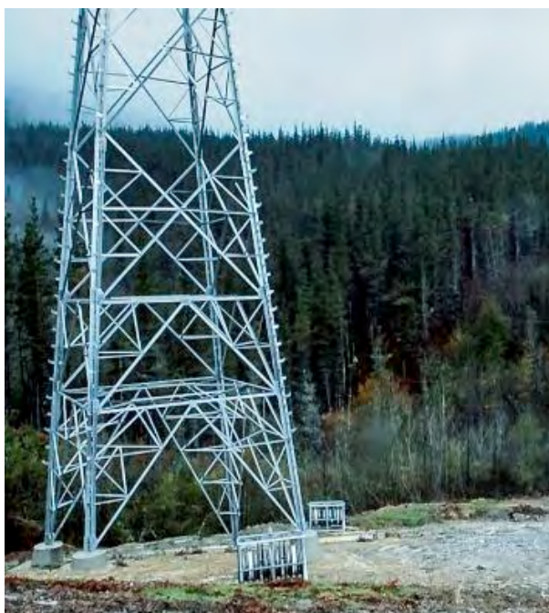
Imagen 26. Torre de alta tensión en monte
