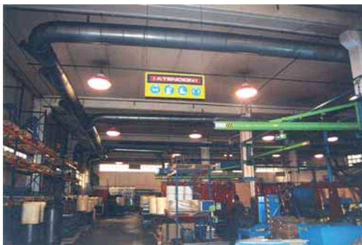
Soldadura nabe bateko aireztapen mekanikoko sistema.
