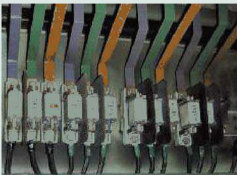
Fusibles sin Separadores Zona del accidente
