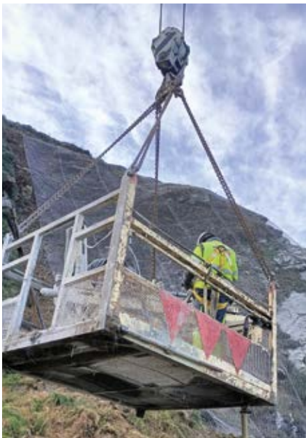
Personal en plataforma con arnés fijado de forma incorrecta a punto de anclaje inseguro.
