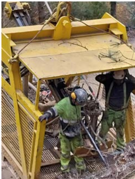
Operario en borde exterior de frente de cesta con arnés sin anclar a punto fijo estructural.
