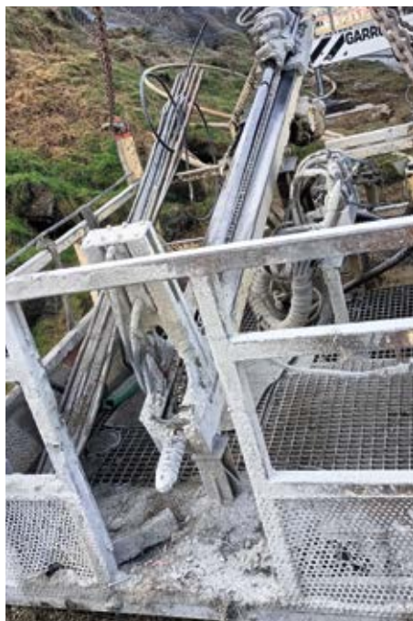
Acceso a cesta inadecuado.
