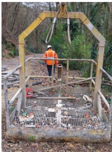
Cestas con perímetro desprotegido, falta protección de borde.
