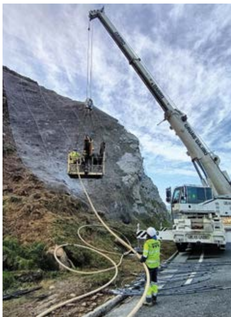
Deficiente control de la nivelación de la cesta, guiado empleando las mangueras de conexión.
