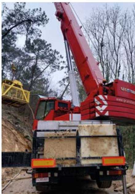
Equipo de trabajo sin asegurar su estabilidad, sin desplegar todos los estabilizadores.
