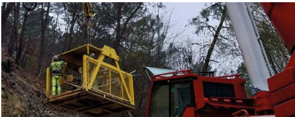
Operación de izado. Operario en borde exterior de cesta sin protección de borde.
