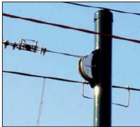
Figura 13. Ejemplo de integración del sistema de compensación en poste.
