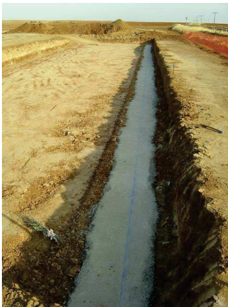
Fotografía de una base de nivelación.
