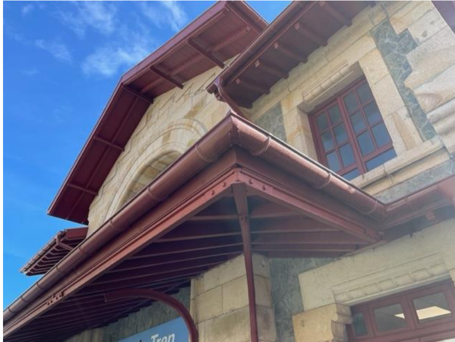
Imagen de fachadas, carpinterías y canalones de recogida de agua de cubiertas tras proceso de rehabilitación de las mismas realizado en el año 2020.
