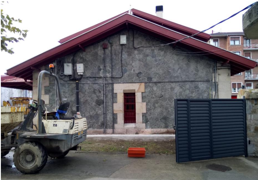
Imagen del alzado lateral Norte durante las obras llevadas a cabo en el año 2020 y finalizada la rehabilitación de la fachada. en ella se aprecian, cajas de registros y diversos cableados que deberán ser retirados como parte de los alcances de este Proyecto Constructivo.
