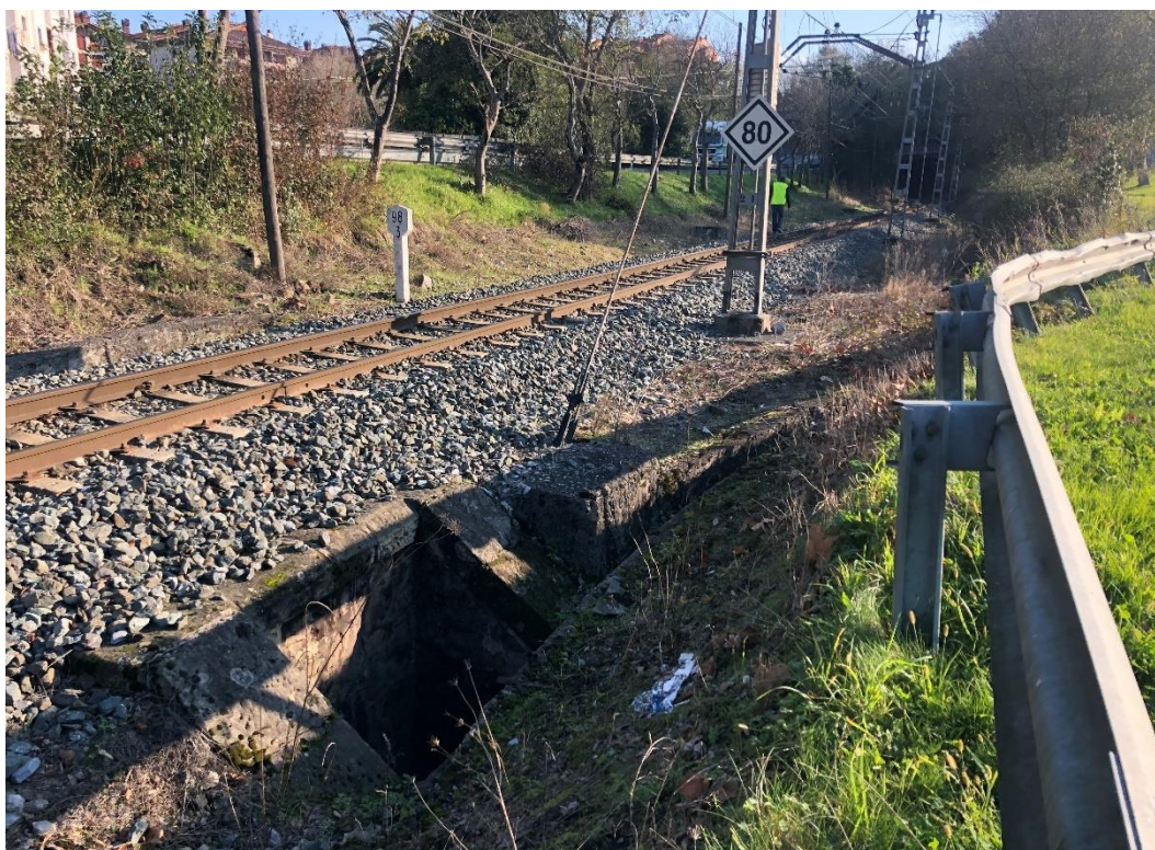
Figura 30. Infraestructura de drenaje afectada por ampliación de plataforma
