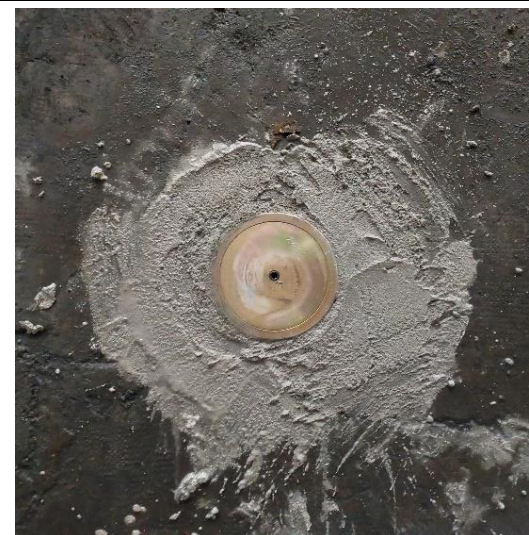
Foto 40. Detalle arqueta ETS-4
