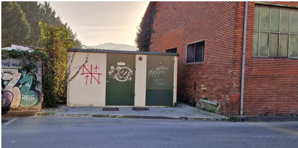
Figura 13. Centro de seccionamiento de Iberdrola (CM ENTERIALDE 901168030). Punto de acometida.
