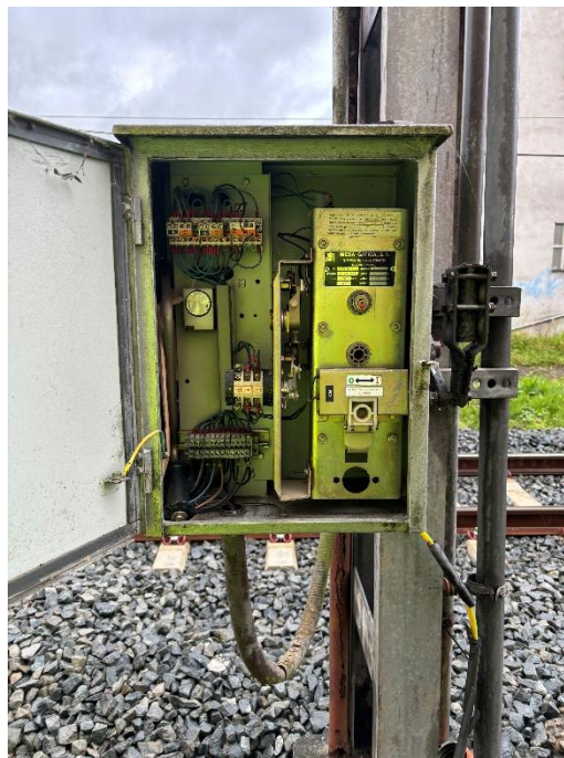
Figura 11. Mando motorizado existente de seccionador de catenaria
