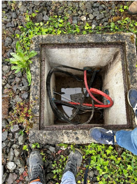
Figura 10. Arqueta LMT (poste 14-18l)
