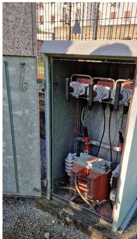
Figura 8. Centro reductor para Est. Gernika
