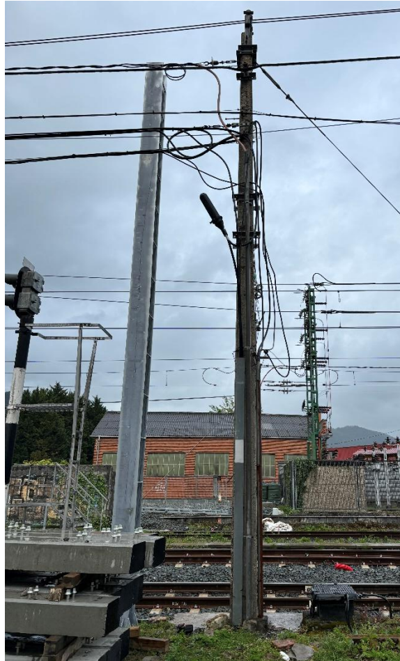
Figura 9. Poste transición soterrado-aéreo LMT (14-18l)
