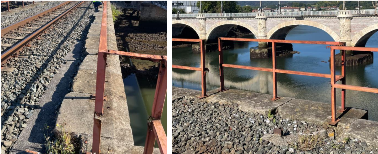
36. irudia. Barandetako kalteak, altzairua herdoildu delako
