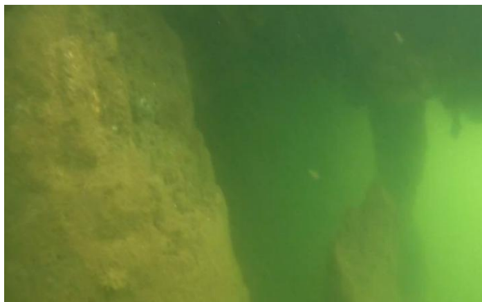
Figura 31. Pila 1. Cavity bajo encepado de pila 1
