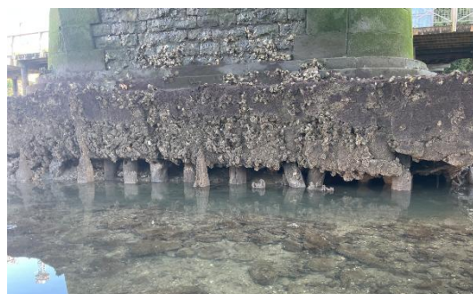
Figura 30. Pila 4. Pilotes descubiertos
