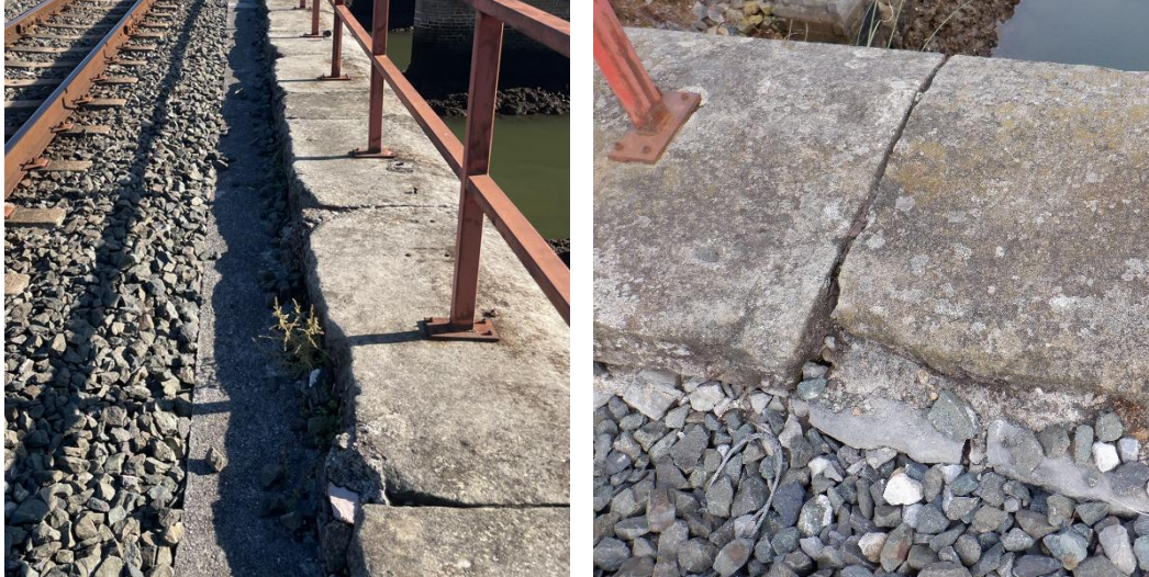
Figura 35. Daños en impostas
