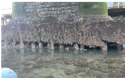
Figura 5. Pila 4. Pilotes descubiertos
