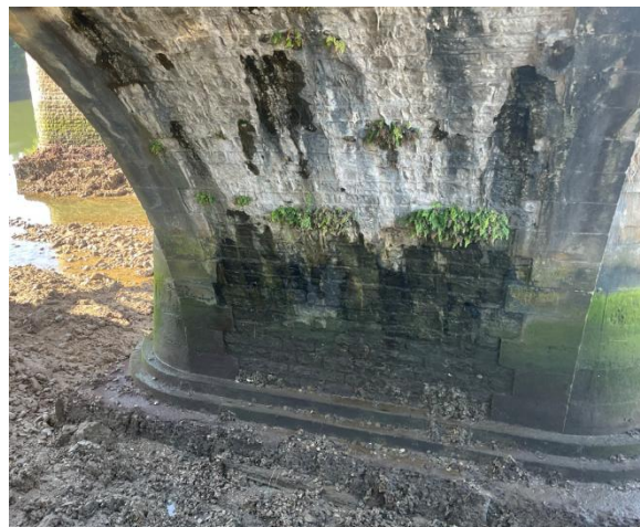
Figura 26. Humedades y verdín en carrera de mareas
