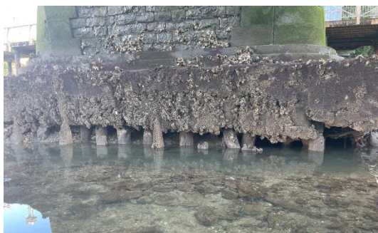
Figura 5. Pila 4. Pilotes descubiertos
