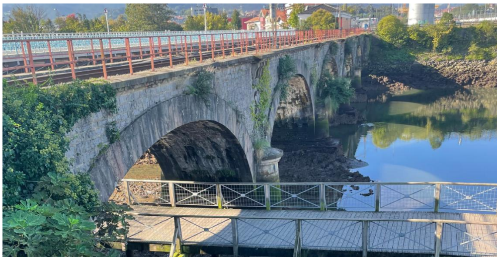
Figura 43. Presencia de vegetación ruderal en las grietas y fisuras del puente
