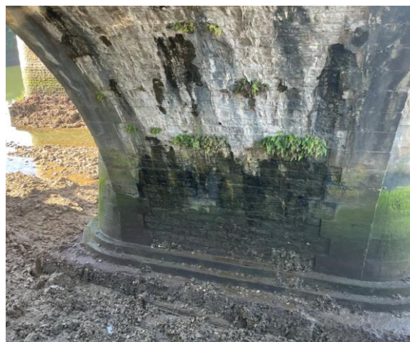
Figura 19. Humedades y verdín en carrera de mareas
