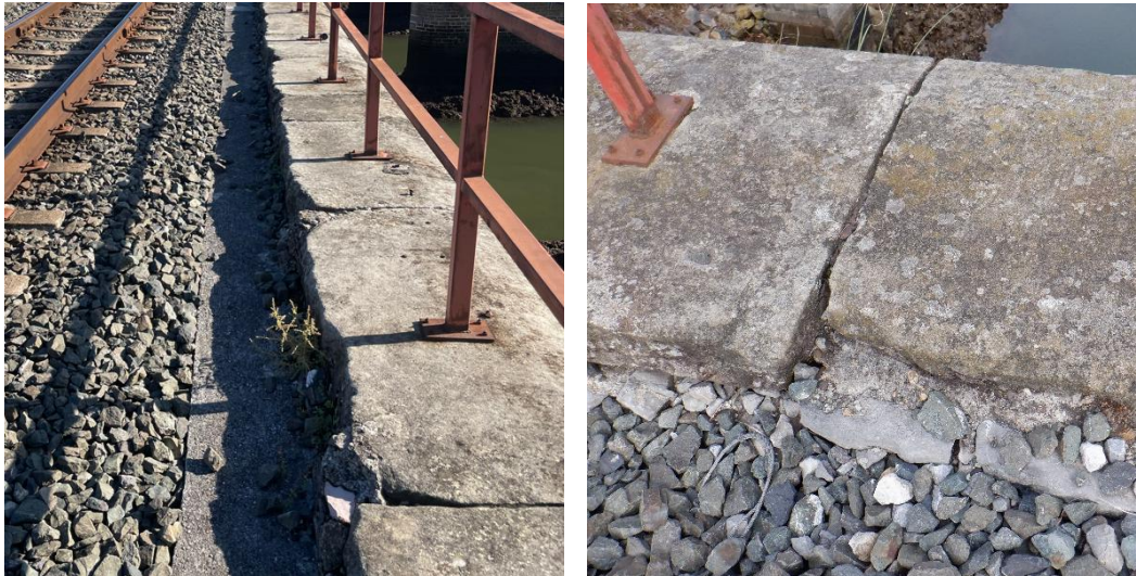
Figura 26. Daños en impostas
