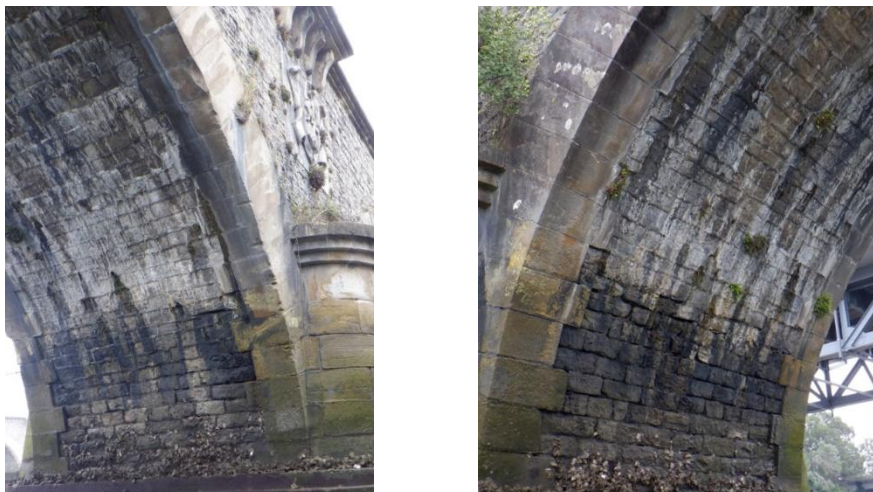
Figura 30. Presencia de humedades y calcificaciones en bóvedas
