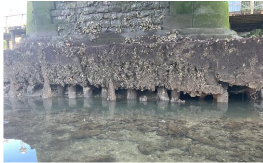
Figura 21. Pila 4. Pilotes descubiertos
