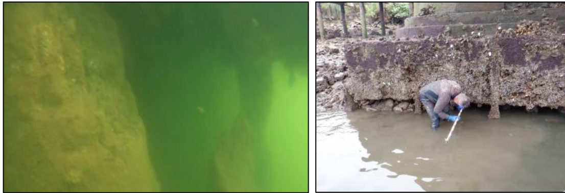
Figura 2. Cavidad bajo encepado de Pila 1 (izquierda) y Encepado de Pila 4, presumiblemente mal ejecutado o con erosión desu parte inferior (derecha).
