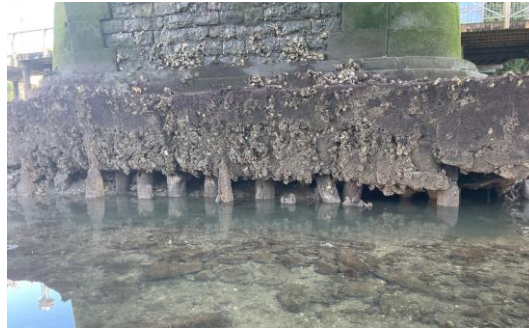
Figura 13. Pila 4. Pilotes descubiertos
