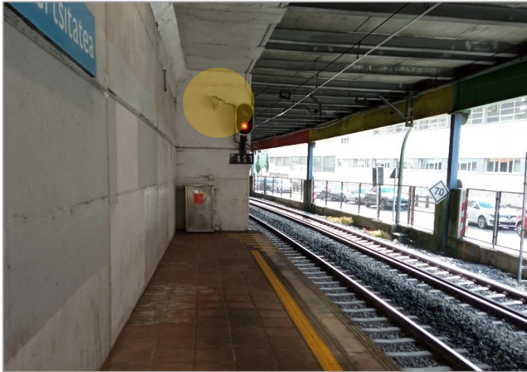
Sistema de videovigilancia situado en el fondo del andén
