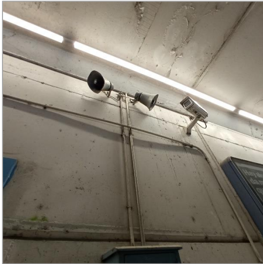
Sistema de videovigilancia y megafonía.
