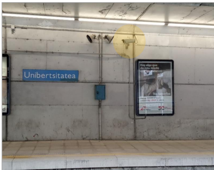
Sistema de videovigilancia situado en el centro del andén
