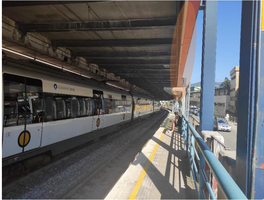
Luminarias existentes en el andén con sentido Bilbao de la estación Unibertsitatea-Eibar.
