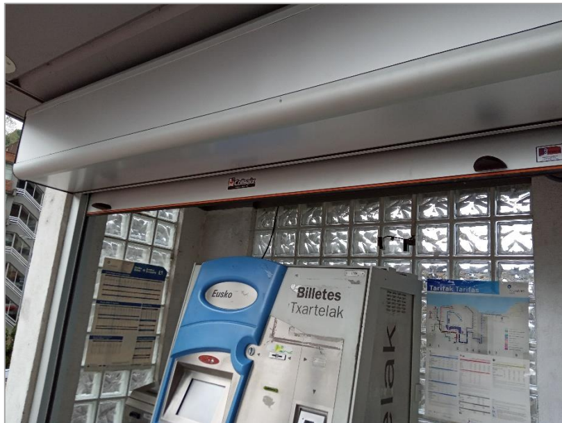
Persiana eléctrica en plataforma de máquina expendedora y canceladora.
