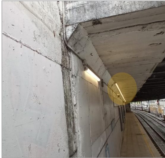
Sistema de videovigilancia situado frente al acceso por escaleras
