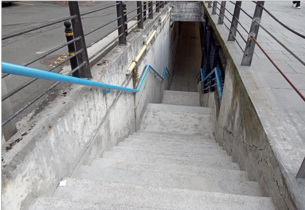
Estado actual del acceso al andén.
