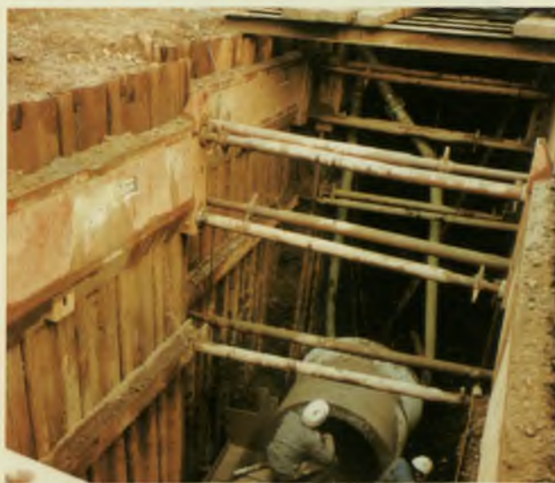
Fig. 55. Detalle del trabajo en el interior de una zanja ancha sobre la que circula una excavadora
