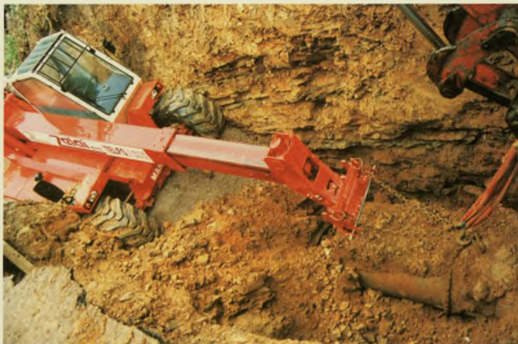
Fig. 2. Accidente mortal ocurrido en una zanja cuando colocaban tubería para saneamiento
