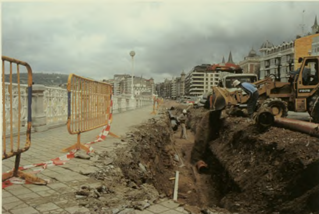
Fig. 4. Peligro de derrumbe en una zanja por falta de protección
