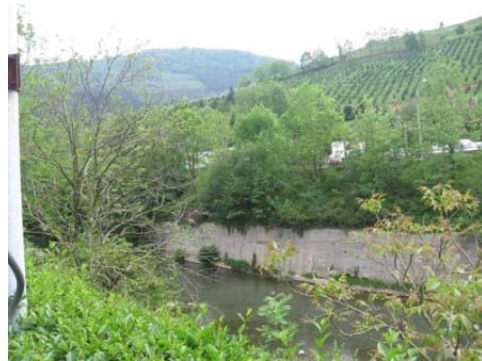
Margen izquierda encauzada en el entorno del actual aparcamiento de Muebles Danona
