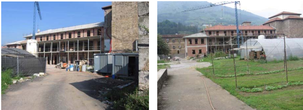
Vista de la zona en obras del Convento de las Franciscanas desde el huerto.
