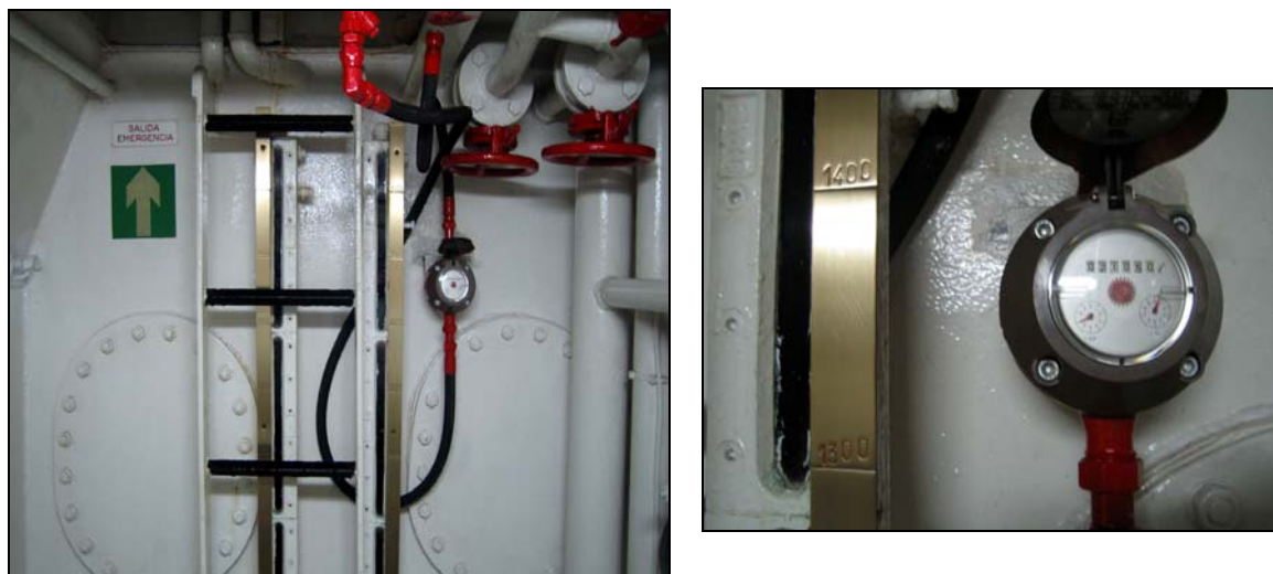
Figura 2: Contador de gasoleo instalado en la salida del tanque de combustible de servicio diario para la medición de consumos.
