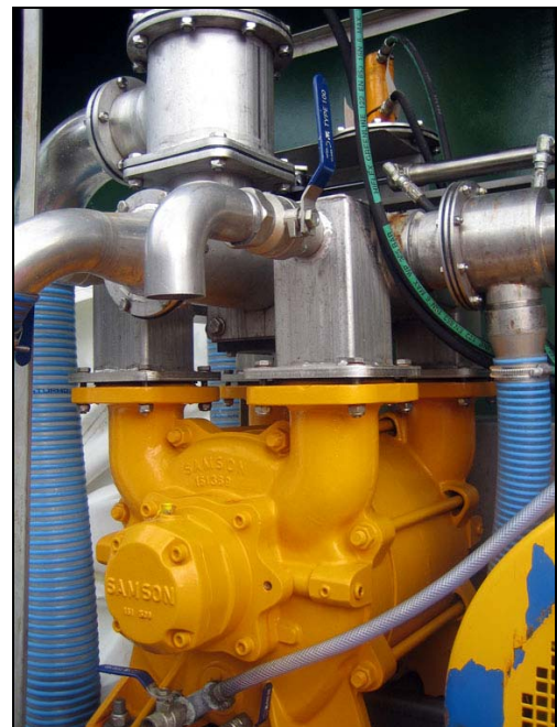
Figura 7: Motor hidráulico (izda.) y bomba de anillo líquido (dcha.)
