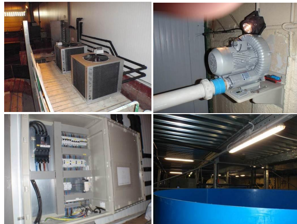
Fig.10. Componentes particulares instalados. Sistemas de refrigeración de agua; soplantes de aire; cuadros electrógenos y luminarias sobre los tanques y pasillos.
