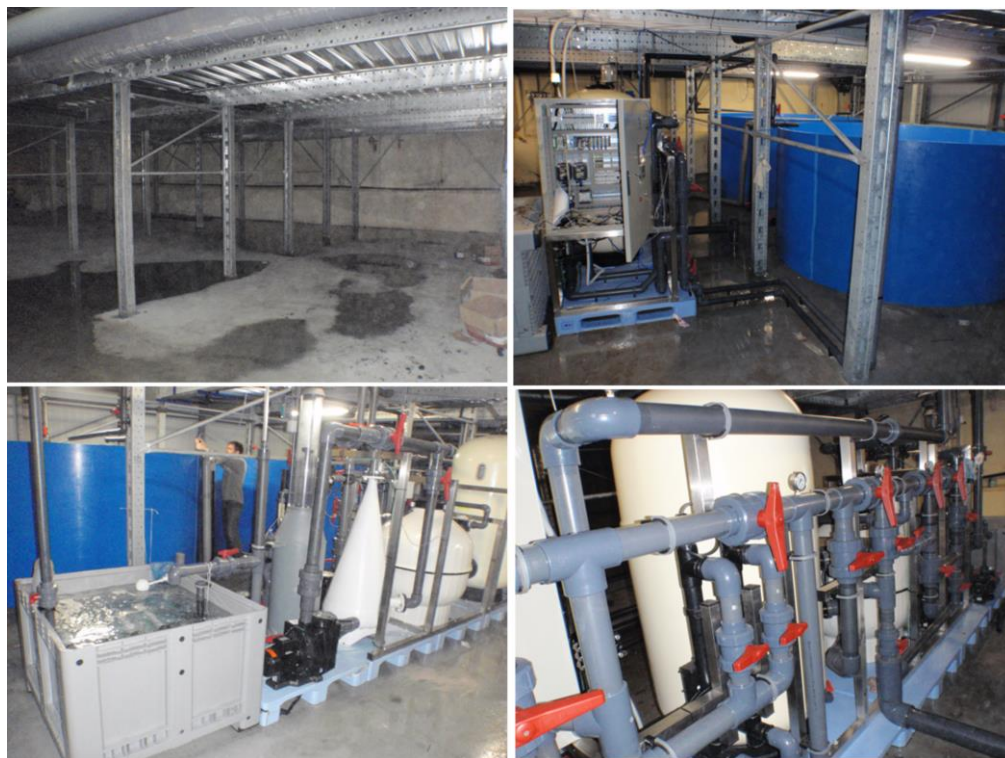
Fig.9. Detalles de la instalación realizada. Aislamiento; cuadro de control; módulo con componentes de tratamiento de agua; y línea de tuberías para caudal primario.
