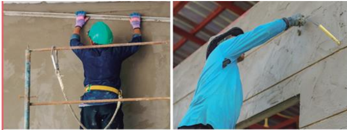
Trabajadores con los brazos por encima del nivel de los hombros, posiciones que requieren además extensión de cuello y espalda
