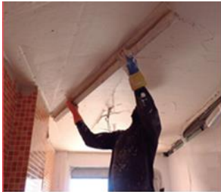
Tarea con riesgo de síndrome del túnel carpiano
