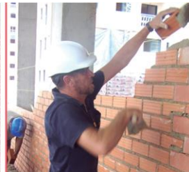
Tareas con riesgo de tendinitis del manguito de rotadores
