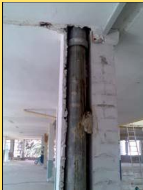
Bajantes de agua
