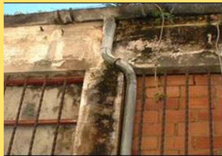
Canalón y bajante de aguas
