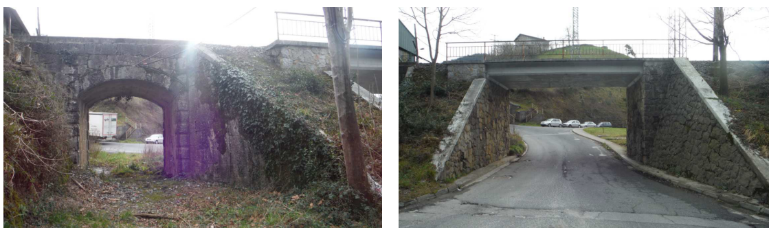
Vista del actual paso inferior y de la OF original adyacente, en desuso
