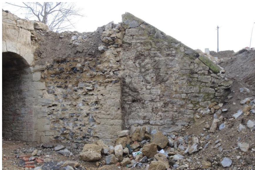
Figura 57.- Daños de la aleta aguas abajo de la alcantarilla de la margen izquierda
