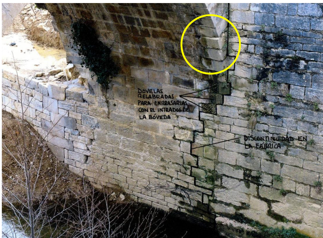
Figura 50.- Daño localizado en la boquilla aguas abajo de la bóveda izquierda
