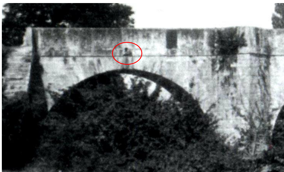
Figura 32.- Antiguo vieiteguas y bocacaz del pretil aguas arriba colocado en el centro del arco
