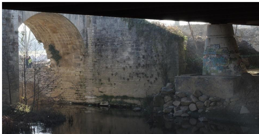
Figura 6.- Fuerte presencia e impacto visual de una de las aletas aguas abajo, sin función al excavar los terraplenes del acceso
