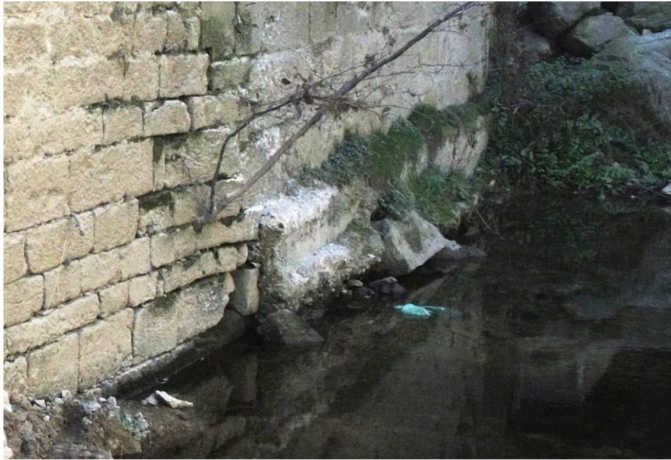
Figura 49.- Descalce de la esquina del estribo izquierdo reparado con un macizo de hormigón en masa
