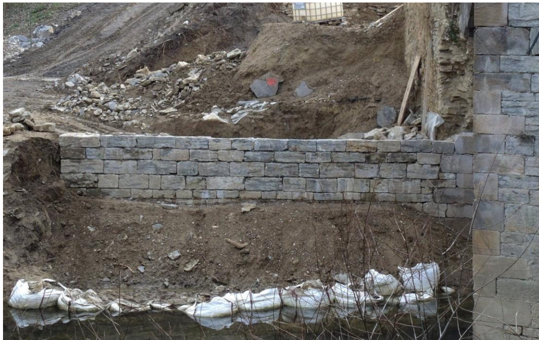
Figura 54.- Reconstrucción parcial de la aleta derrumbada del estribo izquierdo
