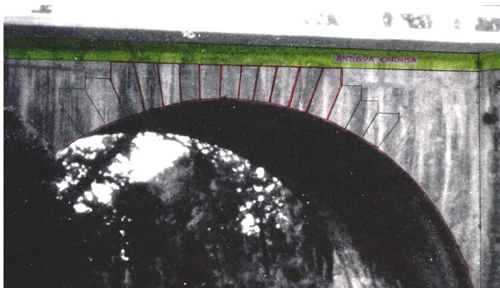
Figura 14.- Dovelas centrales con su trasdós horizontal para apoyo de la antigua cornisa
