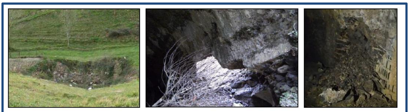
Figura 6. Túnel de ARROA. segundo derrumbe boca salida.
