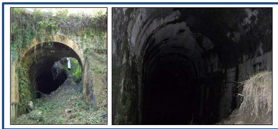
Figura 5. túnel de ARROA. primer derrumbe boca salida.
