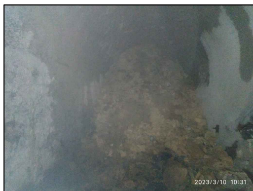
FOTO 5. DESPRENDIMIENTO FONDO P.K. 9+572
