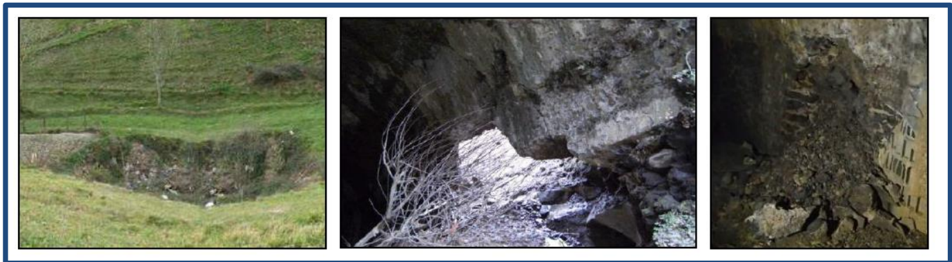
Figura 6. Túnel de ARROA. segundo derrumbe boca salida.
