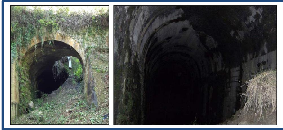
Figura 5. túnel de ARROA. primer derrumbe boca salida.
