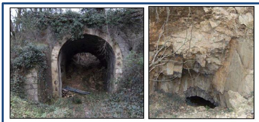
Figura 2. Túnel de IRAETA. Hundimiento falso túnel boca de salida.
