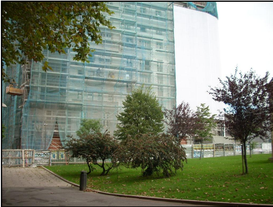
Foto 9. Vista de un edificio en obras ubicado en las inmediaciones de la plaza Euskadi, junto al cual se proyecta uno de los accesos a la estación del Parque.
