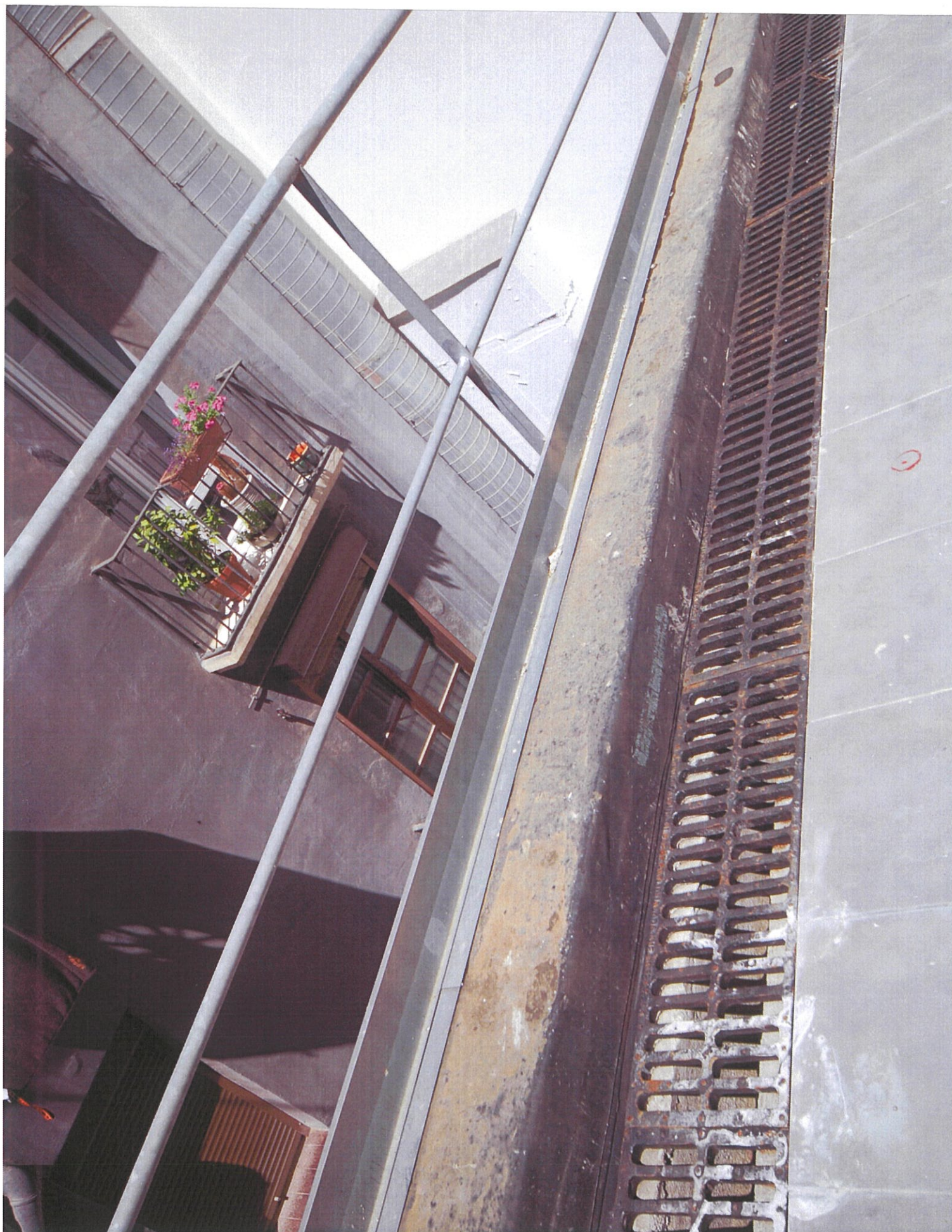
F 25 :TERRAZA FRONTON VISTA REJILLA SUMIDERO DESAGUE TERRAZA
