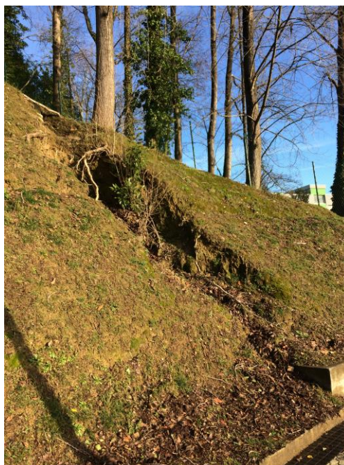
Imagen 8. Deslizamiento del terreno en la esquina sureste, en el talud hacia la rotonda de Berio
