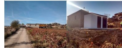
F3_LA PABELLON APIEROS y TRANSFORMADOR ELECTRICO
