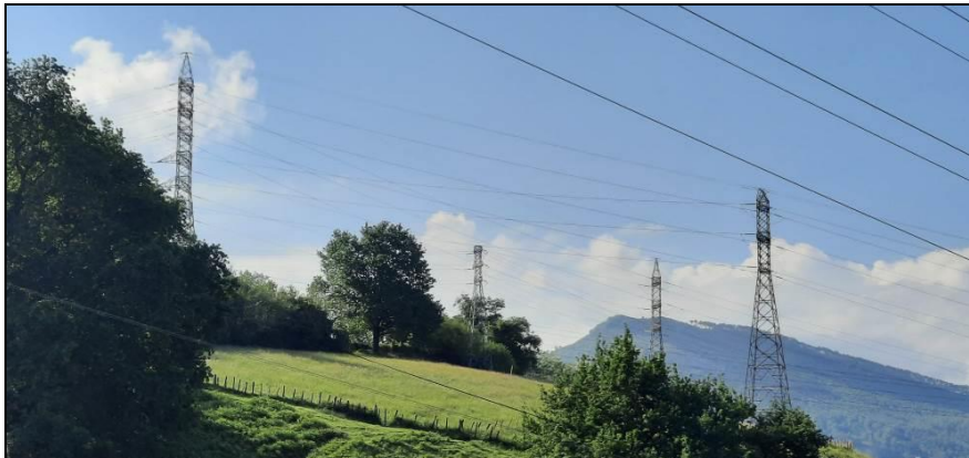
Fotografía 19. Vista del apoyo 10003 desde donde salen las 2 líneas Hernani Oiartzun hacia la ST Hernani (izquierda) y de los 2 apoyos 10002 de las mismas líneas (derecha). Se mantendrá el apoyo más a la derecha en la imagen.
