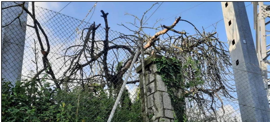
Fotografía 17. Vegetación muerta junto al apoyo 10001 de la línea Hernani-Azpeitia a desmontar, lugar donde estará el nuevo apoyo 19001 proyectado.
