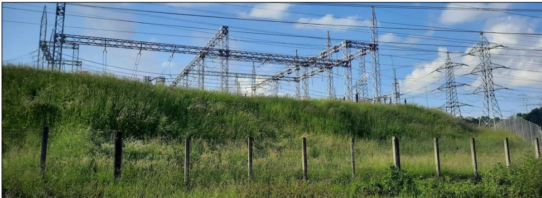
Fotografía 14. Ubicación de los apoyos 20060N y 10001N proyectados, dentro de la subestación.
