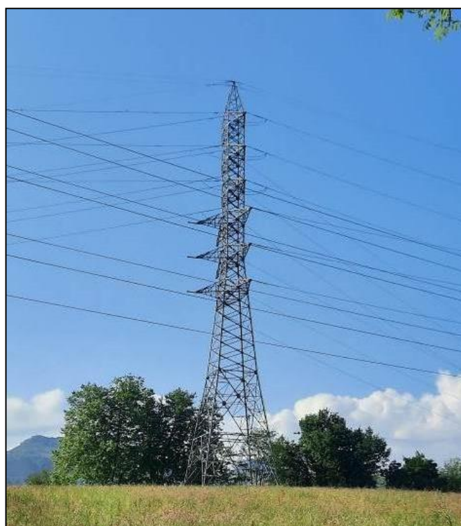
Fotografía 22. Vista del apoyo 10003 existente de la línea Hernani-Oiartzun.
