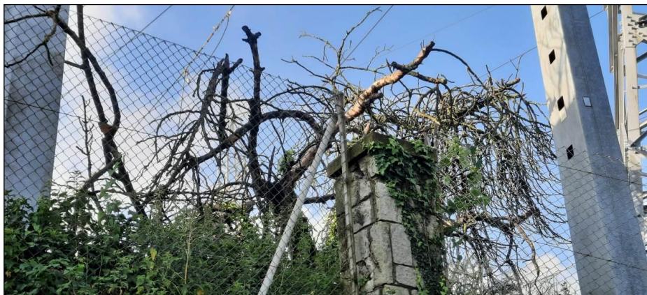
Fotografía 17. Vegetación muerta junto al apoyo 10001 de la línea Hernani-Azpeitia a desmontar, lugar donde estará el nuevo apoyo 19001 proyectado.
