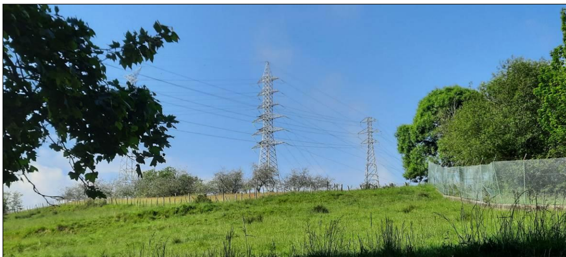
Fotografía 21. Vista desde el este del ámbito de estudio. En el centro, apoyo 10003 de la línea Hernani-Oiartzun, y a su derecha, apoyo 10002 del tramo de la misma línea a mantener.
