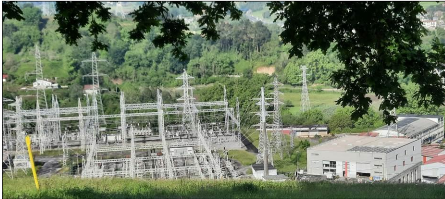
Fotografía 18. Vista general de la subestación ST Hernani. Las líneas y apoyos a desmontar se encuentran entre la subestación y el polígono.
