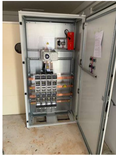
Ilustración. Envoltorio metálico del CGBT
