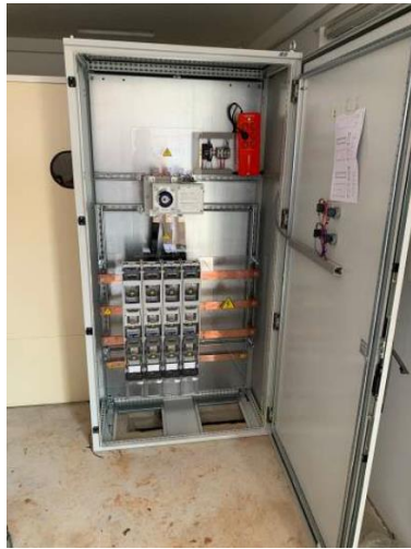
Ilustración. Envoltorio metálico del CGBT
