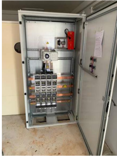
Ilustración. Envoltorio metálico del CGBT
