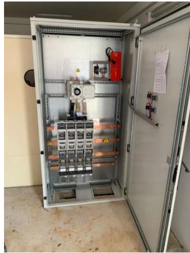
Ilustración. Envoltorio metálico del CGBT
